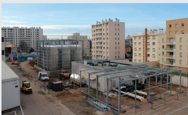
D'une capacité de stockage de 1 200 m 3 d'eau chaude, soit environ 48 MWh, il permettra de restituer 12 MW en heures de pointe pendant 4 heures. Sa mise en service est programmée en juin 2021.
